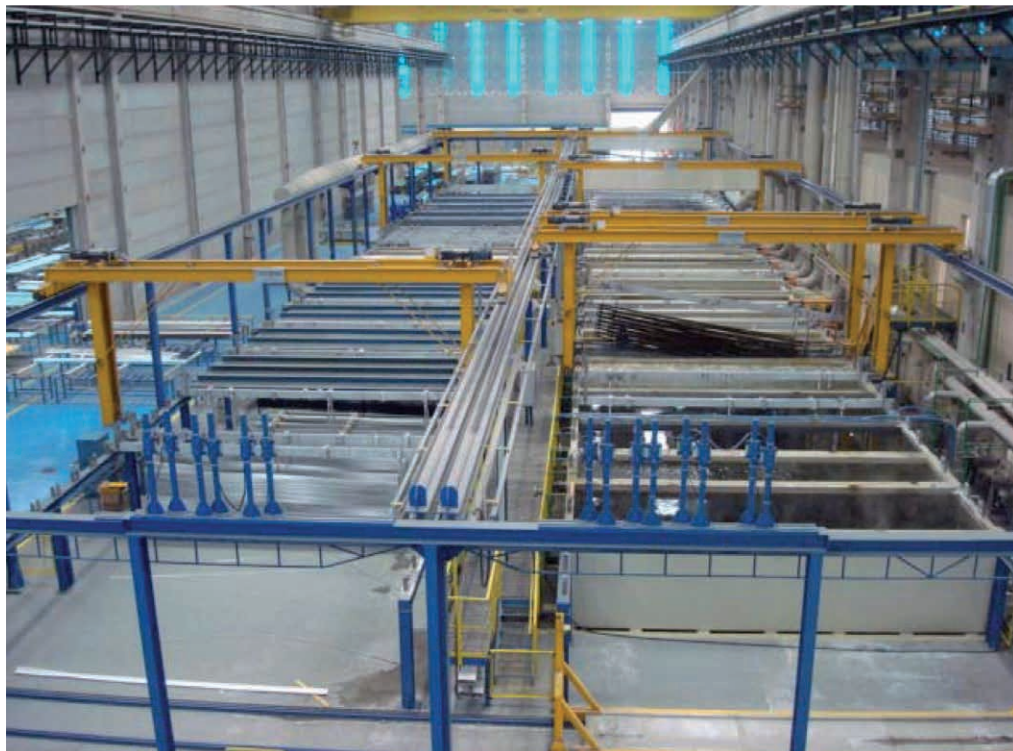
3 - Il nuovo impianto di anodizzazione di 1000 t della VM/CBA La nouvelle installation d'anodisation de 1000 t de VM/CBA.
